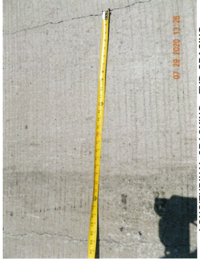
LONGITUDINAL CRACKING - TYP. SPACING
